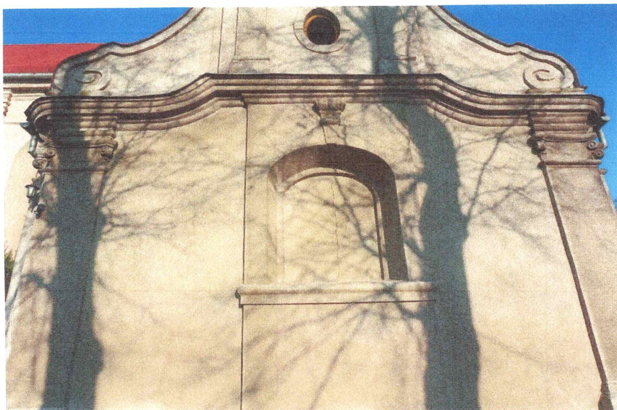
Fot. nr 6 Pęknięcie pionowe na prawie całej wysokości muru
