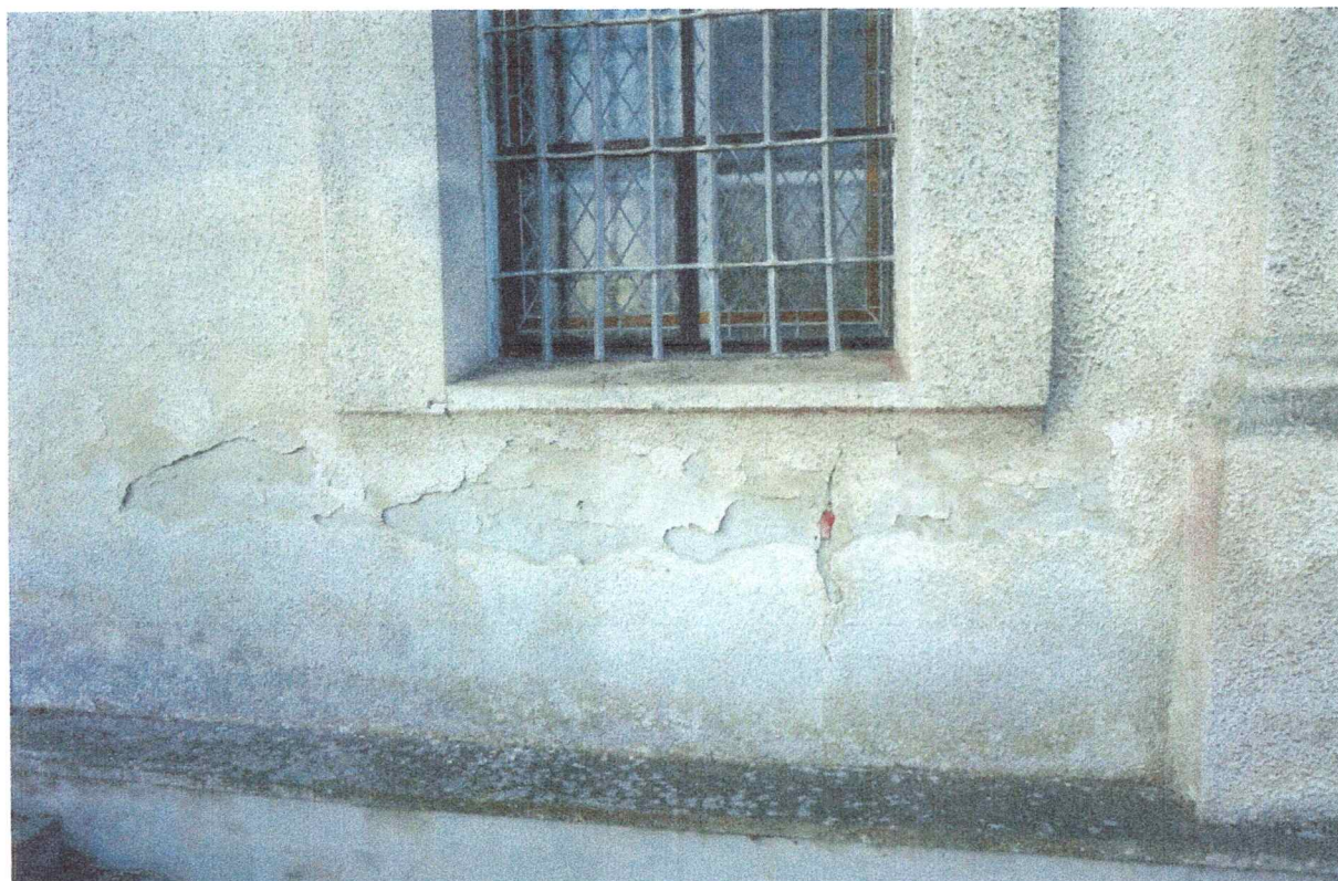
Fot. nr 12 Wysolenia na ścianie zewnętrznej
