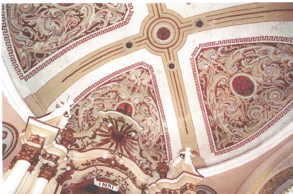
Fot. nr 10 Pęknięcie sklepienia
