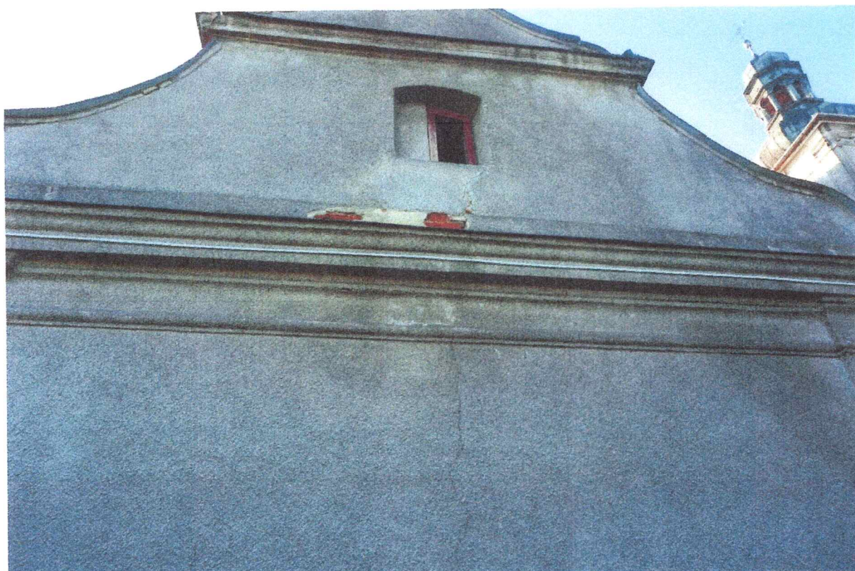
Fot. nr 5 Pęknięcie pionowe na całej wysokości muru, zniszczony gzyms
